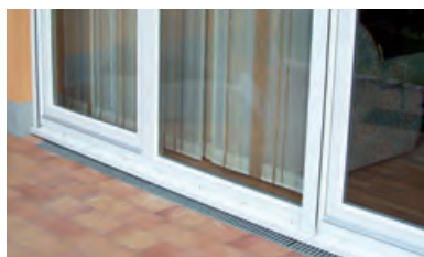
Geschlossene Rinne mit Anschluss an die Versickerung: Fassade mit ACO Self® Hexaline
