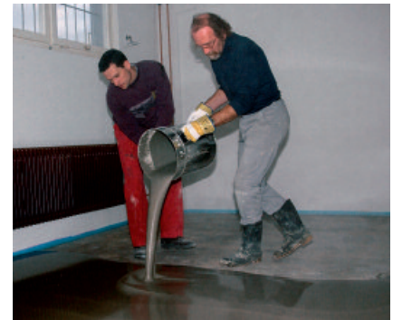
Rationeller und wirtschaftlicher Bodenausgleich mit PCI Periplan vor dem Verlegen von Oberbelägen.
